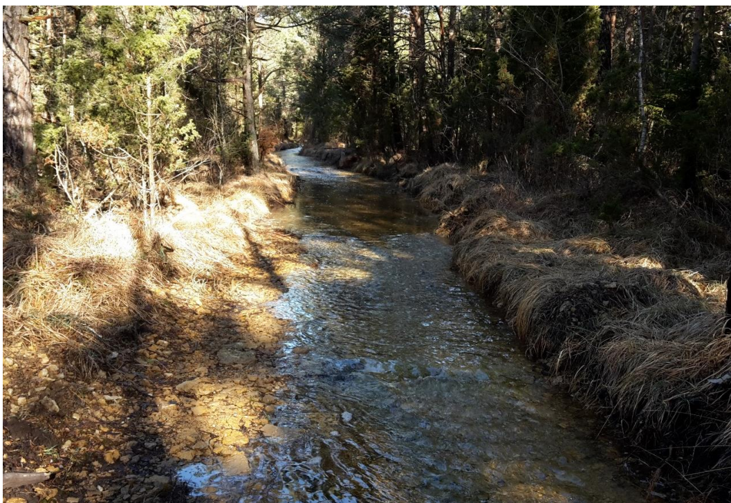
Figur 11. Rensade och kraftigt breddade diken/bäckar för dränering av skog. Den övre bilden visar diket under sommartid och den undre bilden diket under vintertid. Schaktningen är gjord ner till kalkhällen i alla delar.
