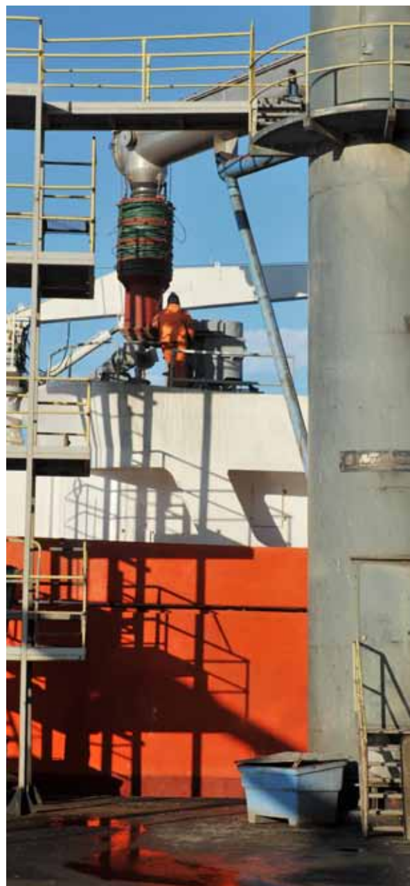
Fartygen fylls via en grov rörledning som ansluts med en strumpa till fartygets eget distributionssystem. På bilden är Västanvik på väg att anslutas. Foto SOA 2010
