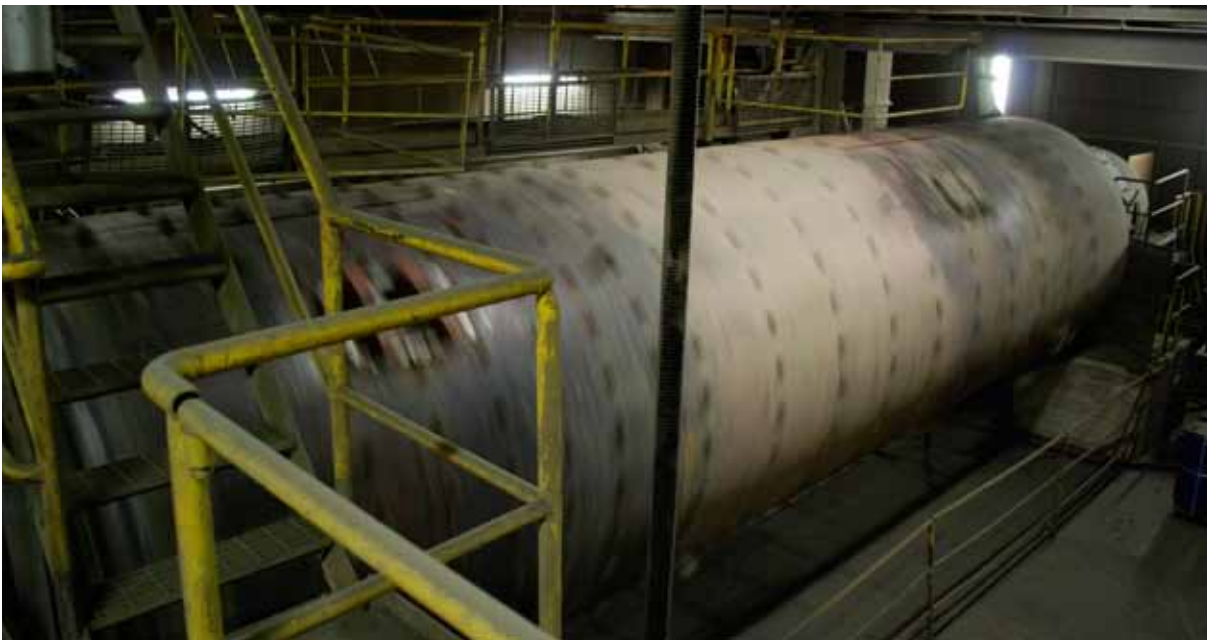
Ljudnivån här vid cementkvarn 4 i drift är mycket hög. Kvarnen är av fabrikat FLS och byggdes år 1966. Kapaciteten ligger på 42 ton per timme och trumman roterar med 17,5 varv per minut. Foto LKU 2010
