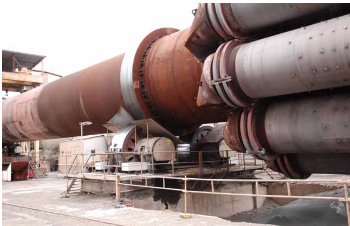
Roterugnen i Skövde är försedd med en planetkylare som syns i höger bildkant. Foto SOA 2008
