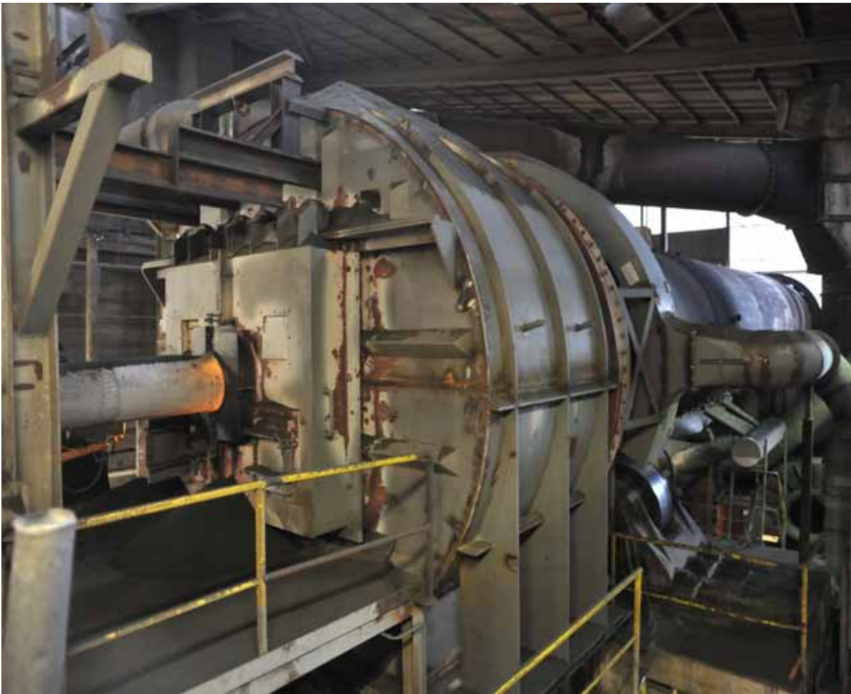
Brännarplan vid ugn 3 där den rödglödgrade brännarlansen sticker in i ugnen genom en isolerande skjutport som dras åt sidan då man behöver komma in i ugnen för service och underhåll. Strax framför rullagret syns den mantel som suger upp eventuella ugnsgaser som läcker ut i omgivningen. Längs sidan av ugnen sitter ett ventilationsrör med munstycken vinkelrätt mot ugnsmanteln. Röret används för att styra kylluft mot den varmaste delen av ugnen så att tegelinfordringens livslängd kan ökas. Foto SOA 2010
