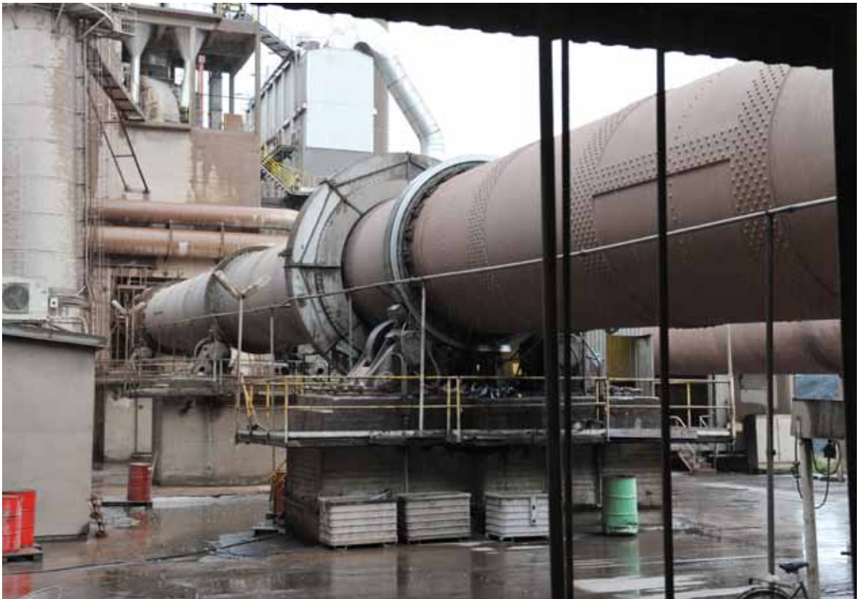
Ugn 3 är lagrad vid fem ställen längs den 88 meter långa ugnsmanteln. Under plåthöljet centralt i bilden finns den kuggkrans i vilken motorns kugghjul greppar in och driver ugnens rotation. Numera drivs båda ugnarna med hydraulmotorer från Hägglunds. Foto SOA 2010
